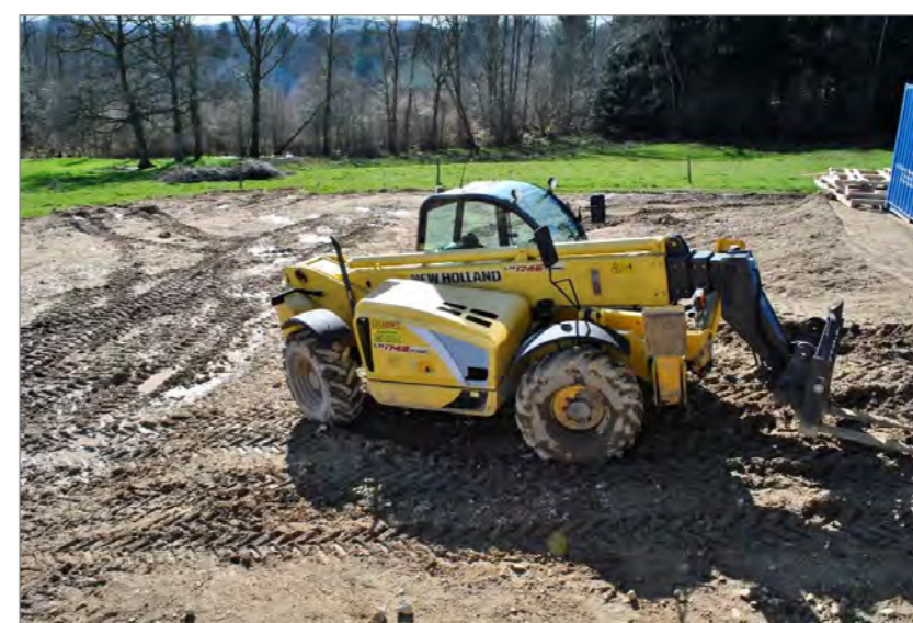
Photographie 30 : Exemple de tassement et d'ornières créés par les engins de chantier
