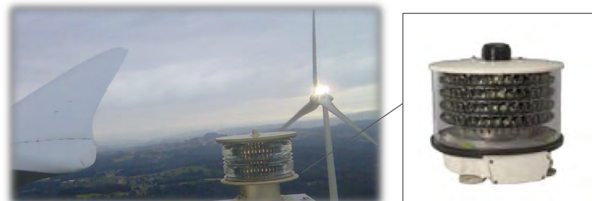
Figure 46 : Balisage d'une éolienne
